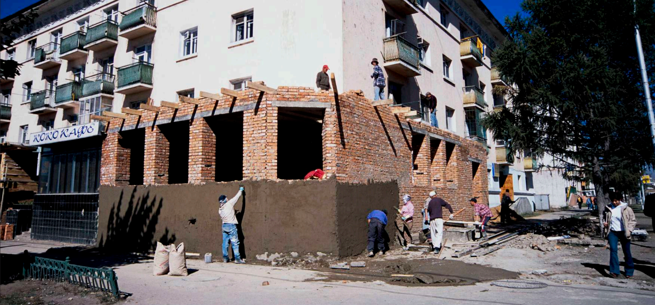
Үйлчилгээний төвүүд орон сууцны 1 давхарт баригдаж эхлэв, 2000 он Service centers started springing up on the ground floor of apartments, 2000
